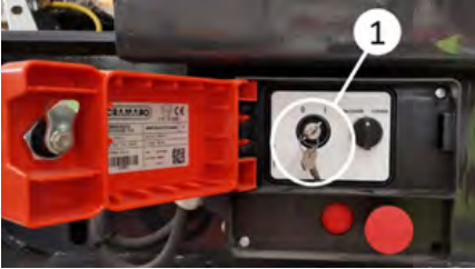
Kontrol ünitesinin açılması
