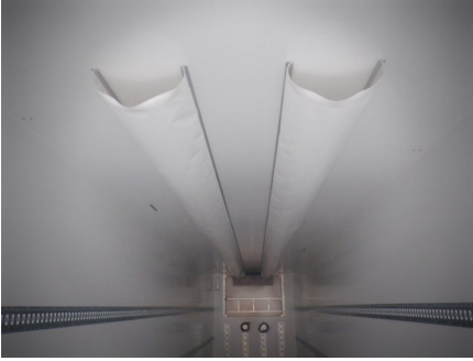
Borulu tip havalandırma kanalı
