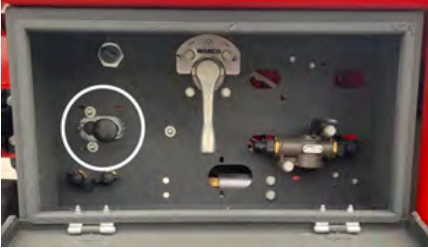
Kumanda dolabındaki dingil kaldırma mantar butonu
