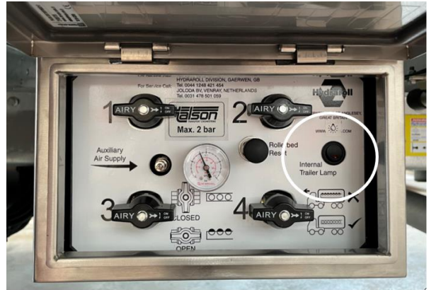
Roller kumanda dolabı iç aydınlatma düğmesi
