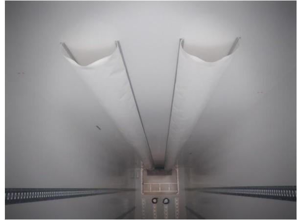
Borulu tip havalandırma kanalı
