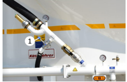
Hava tahliye vanası
