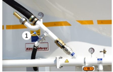
Hava tahliye vanası
