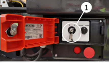
Kontrol ünitesinin açılması
