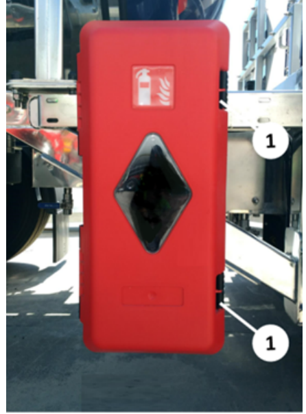
Yangın söndürme tüpü dolabı
