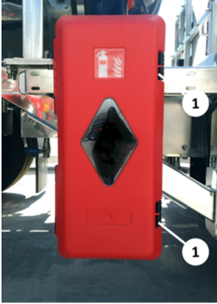
Yangın söndürme tüpü dolabı
