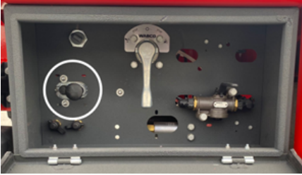
Kumanda dolabındaki dingil kaldırma mantar butonu
